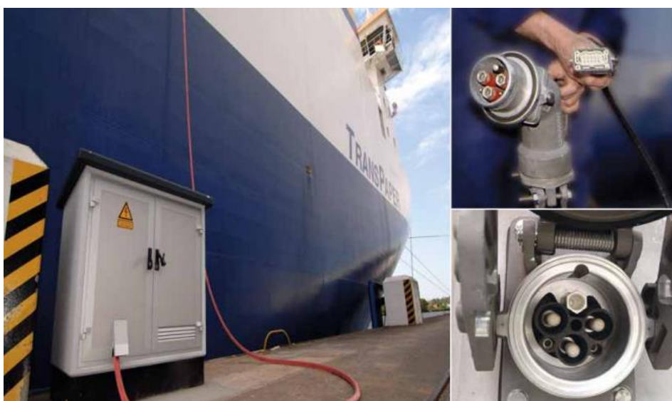
Figura 8 – Alimentação em terra, porto de Oakland, EUA.
