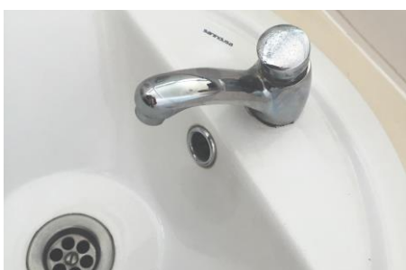
Figura 37 – Torneiras misturadoras e redutoras de caudal.
